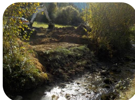
Installation de gîte artificiel (à gauche) et réfection de berges (à droite) en faveur du Desman des Pyrénées. © ANA – CEN Ariège
